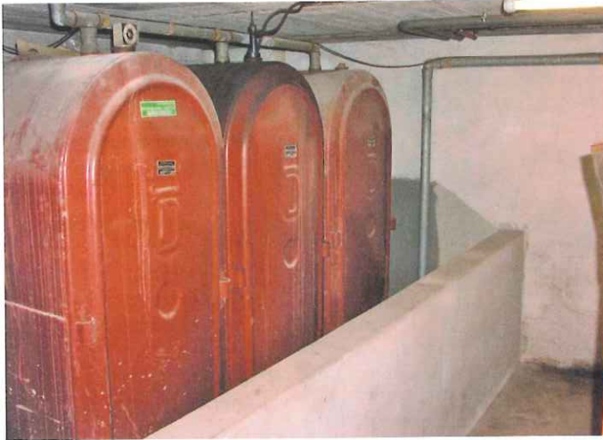
Nicht mehr Stand der Technik: einwandige Kunststofftanks mit Auffangwanne. Bild: Dehoust
