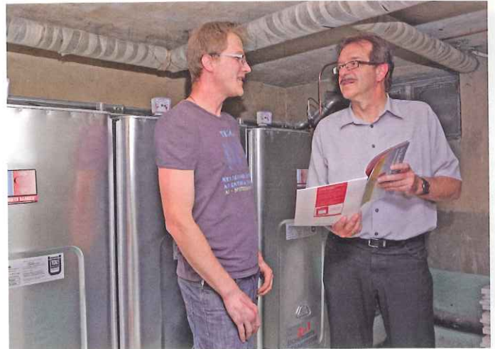
Heizöltanks dürfen nach der neuen AwSV nur noch von Fachbetrieben installiert werden. Bild: IWO
